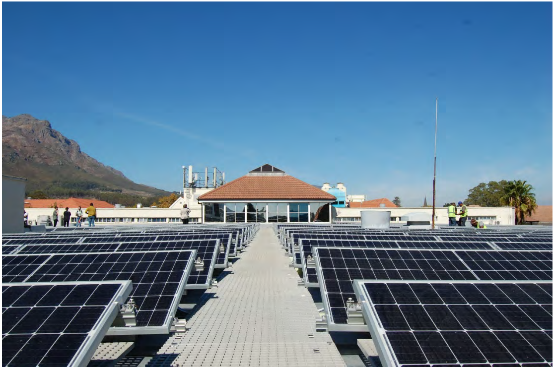
Figuur 22: Die fotovoltaiëse panele op die dak van die Neelsie.
