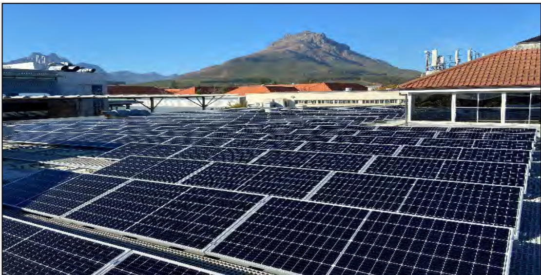
Figuur 57: Fotovoltaïese installasie op die Neelsie se dak
